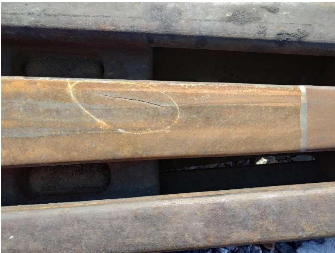
Рисунок 2.2 – Новый вид дефекта крестовин с приварными рельсовыми окончаниями – трещина в продольном шве рельсовых окончаний
