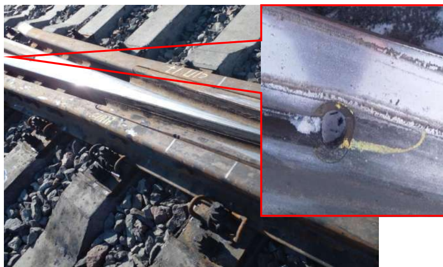
Рисунок 6.9 – Трещина от технологического отверстия при сварке рельсовых окончаний на крестовине № 850
