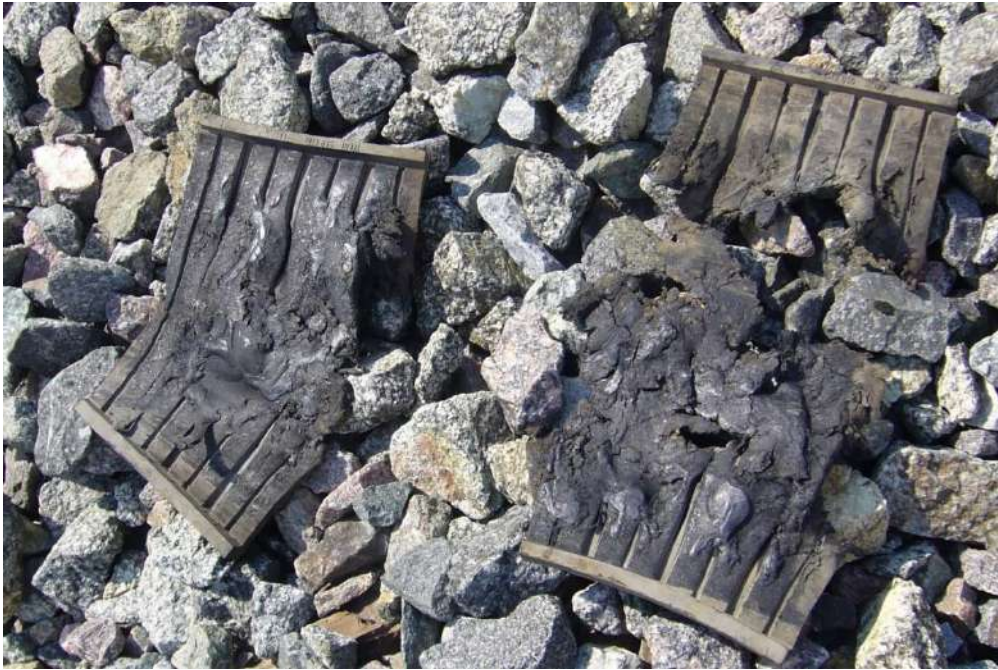
Рисунок 6.4 – Разрушение подрельсовых прокладок в зоне контррельсового узла стрелочного перевода
