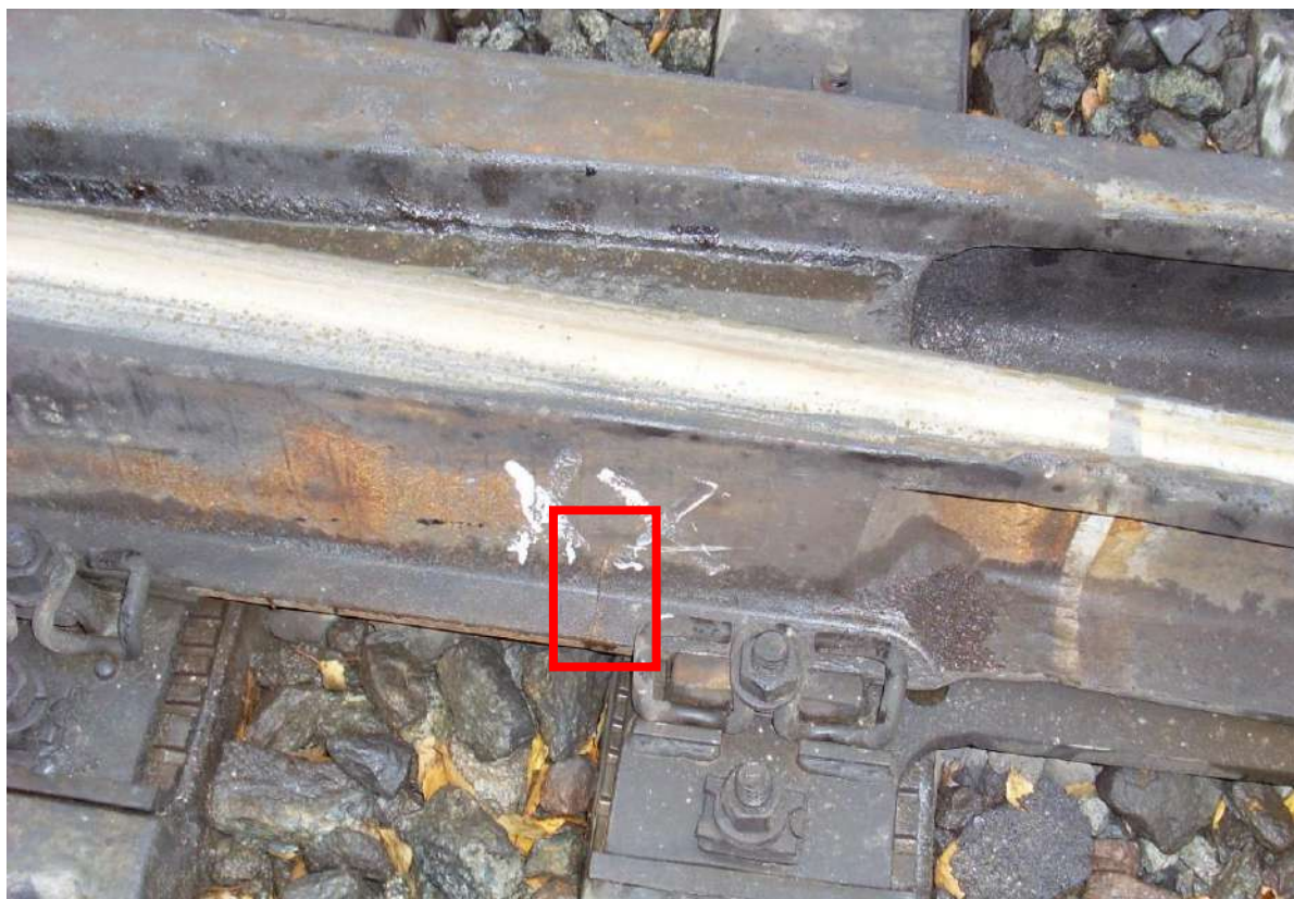
Рисунок 1.8 – Трещина в районе переднего вылета цельнолитого блока моноблочной крестовины
