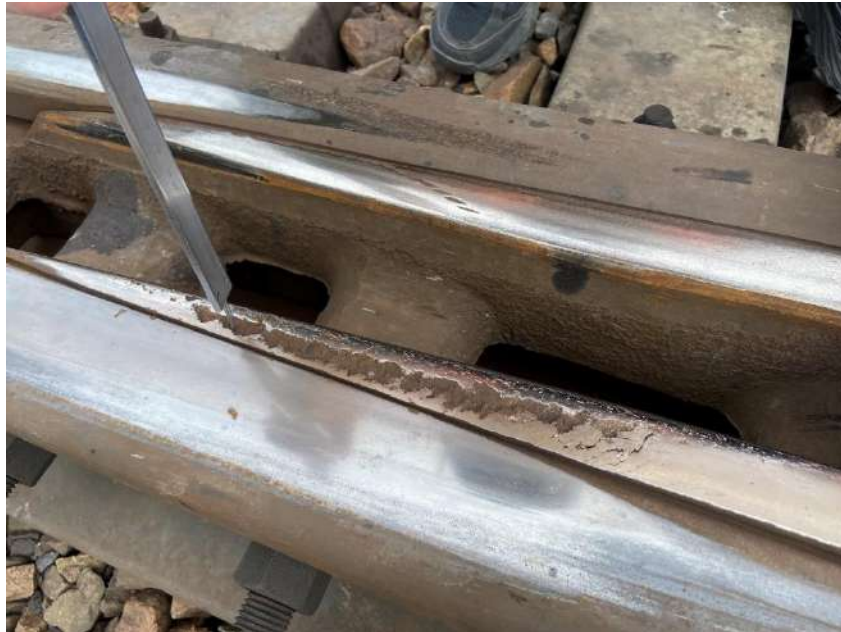
Рисунок 6.8 – дефекта ДУ.14.2 на крестовине № 314
