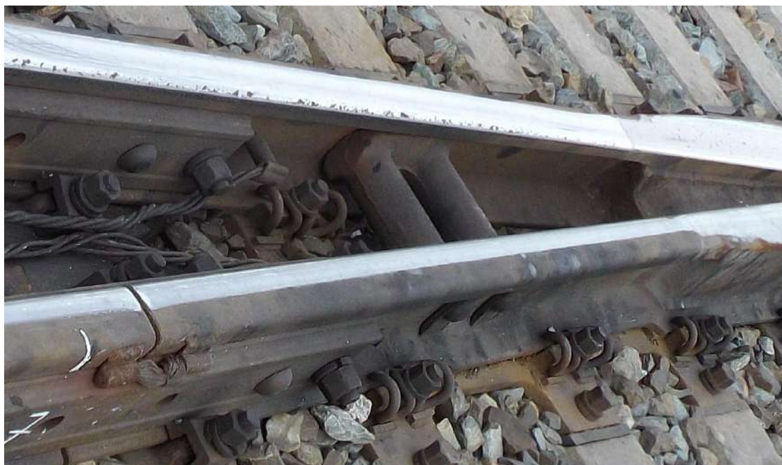
Рисунок 2.3 – Новый вид дефекта крестовин с приварными рельсовыми окончаниями – выкрашивание металла на поверхности катания приварных рельсовых окончаний
