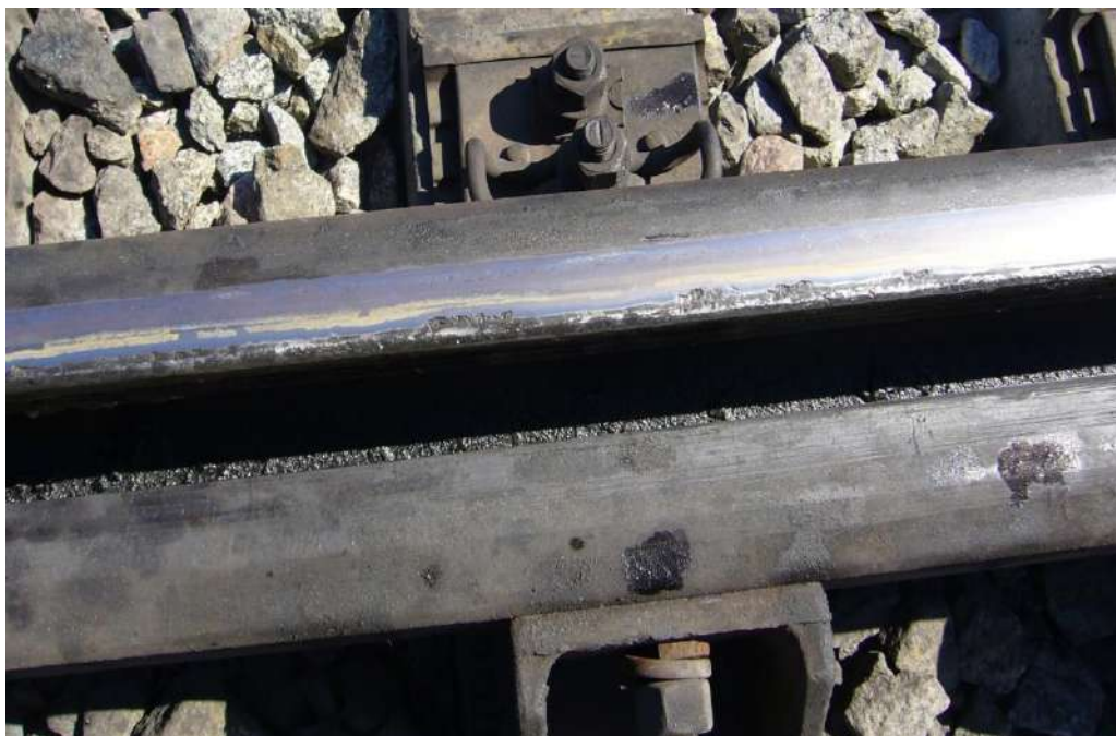
Рисунок 6.5 – Выкрашивание металла поверхности катания рельса крестовины в зоне контррельса прямого направления по дефекту ДХ.11.2
