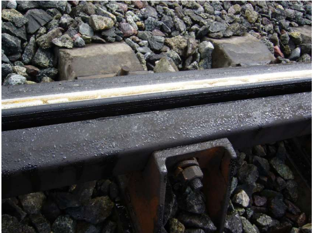
Рисунок 6.1 – Сплыв металла контррельса (дефект ДКу.44.2) из уголкового профиля на стрелочном переводе типа Р65 марки 1/11 проекта Н01.001
